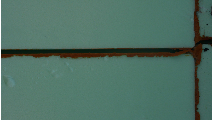
Abbildung 4: Fuge in Perimeterdämmung
